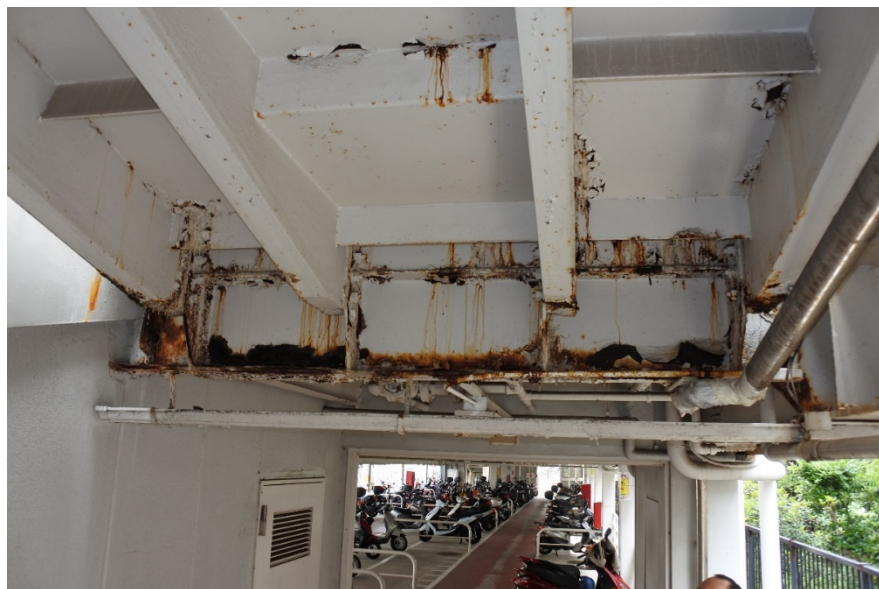
錆びの進行（1986年完成 市営駐輪場内）
