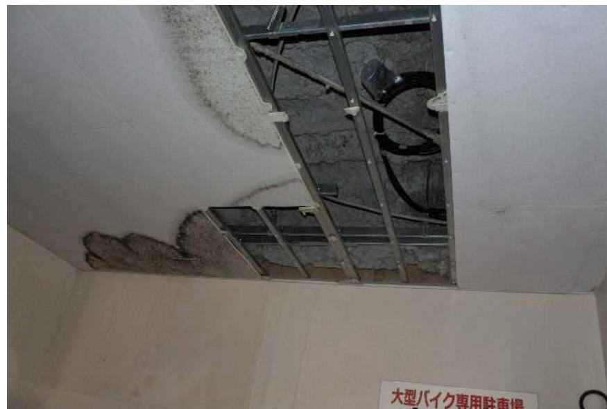
経年的な雨漏り（1980年完成 市営駐輪場内）
